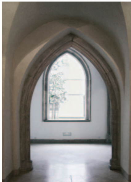
B7 Bývalý dominikánský klášter v Brně, portál do refektáře — pohled z prostoru refektáře.
